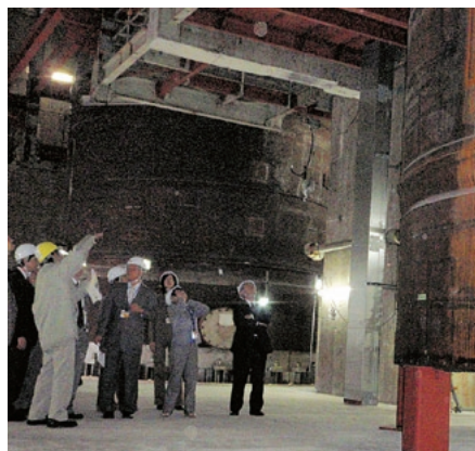
説明を聞きながら巨大な熱交換器を見上げる
