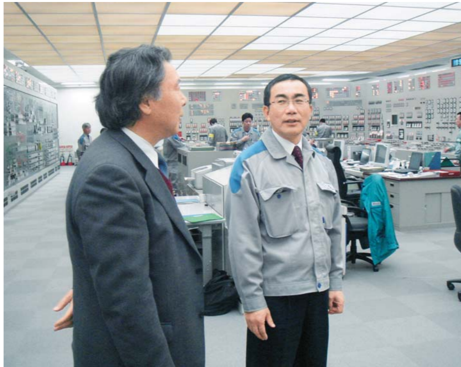
▲中央制御室。各施設・設備のすべてのデータを24時間体制でチェックする。門先生は説明を聞きつつ、表示パネルや運転員の仕事ぶりを丹念に見て回られた。
