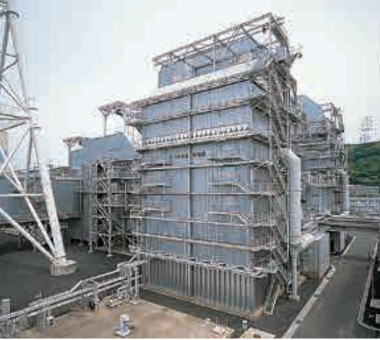
排煙脱硫装置
